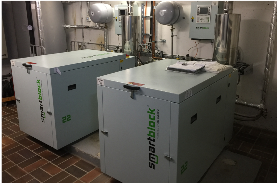
BHKW-Anlage mit 2x 22 kW el
