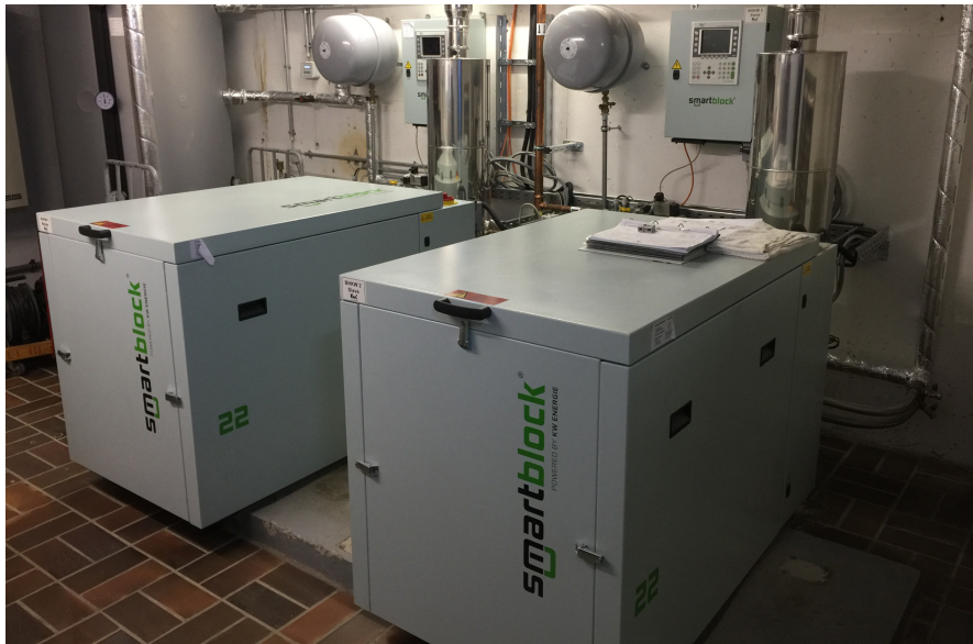
BHKW-Anlage mit 2x 22 kW el
